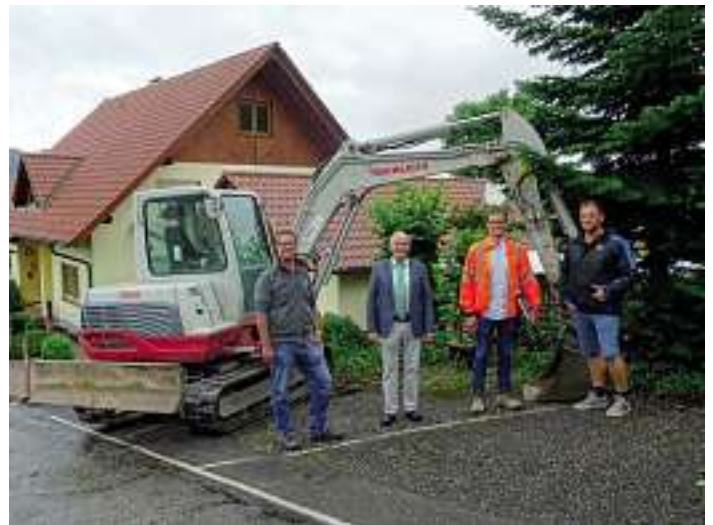
Hauptamtsleiter Bastian Knapp, Bürgermeister Thomas Krechtler, Andreas Huber (Vogel Ingenieure) und Ewald Buk (Ossola GmbH) überzeugten sich vom Baufortschritt
